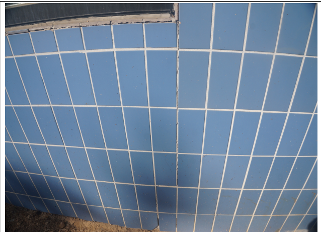
전기실 및 관리동 외부 타일 줄눈부 균열
