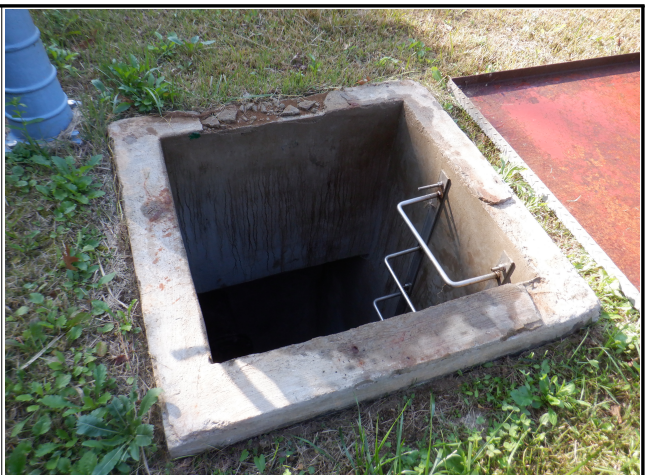
유출밸브실 출입구(외부) 모르타르 파손
