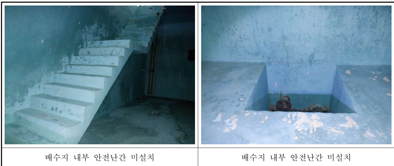
【사진 3.9】 추락방지시설 손상사진
