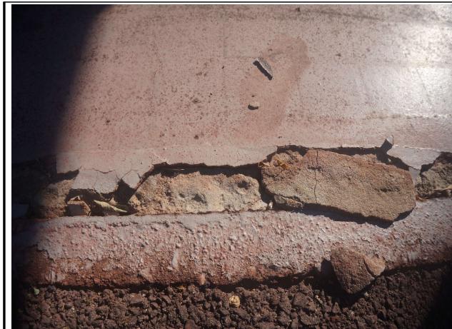
전기실 및 관리동 외부 바닥 파손
