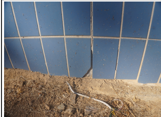
전기실 및 관리동 외부 타일 파손
