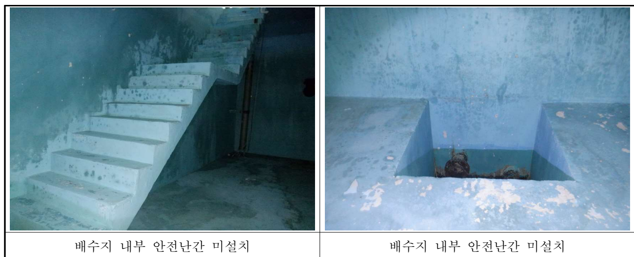
【사진 3.7】 안전시설(점검로) 손상사진
