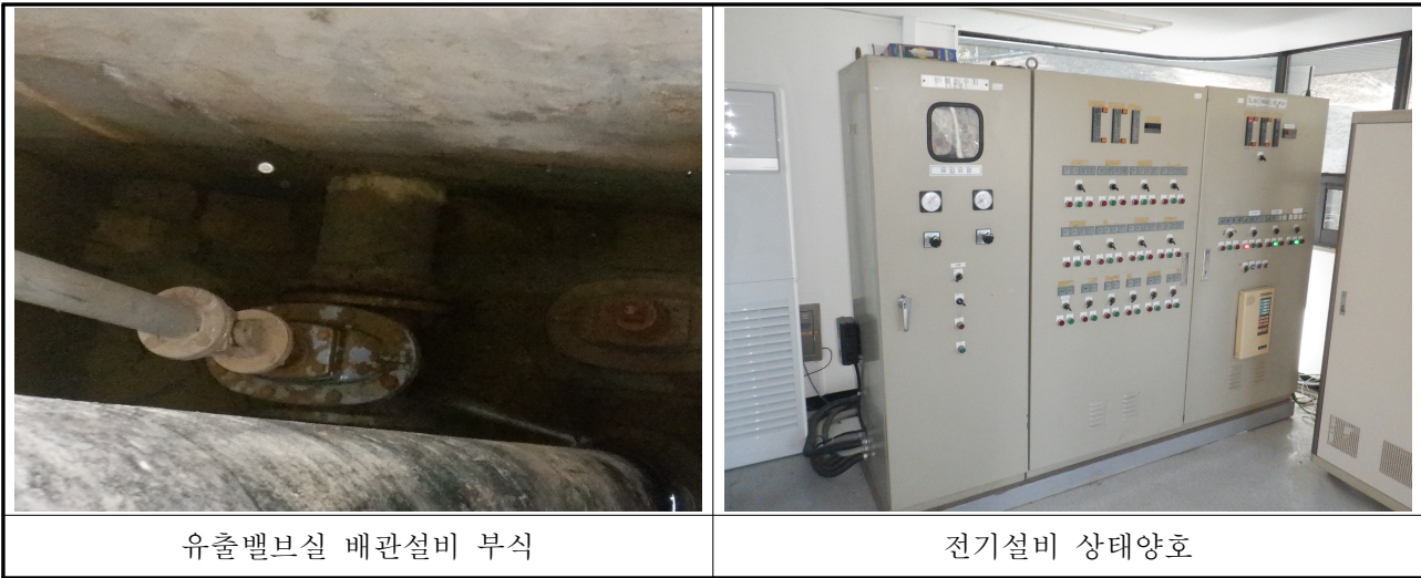
【사진 3.6】 기전설비 손상사진(계속)
